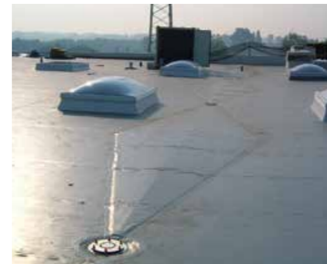
Punktentwässerung entlang der Kehllinien
