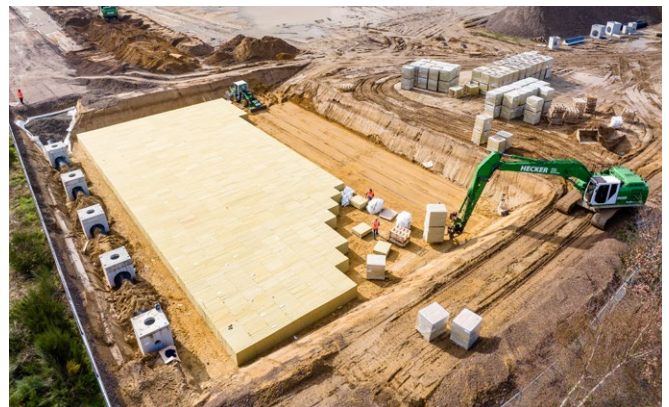
Praktijkvoorbeeld centrale buffer industrieterrein Roermond
